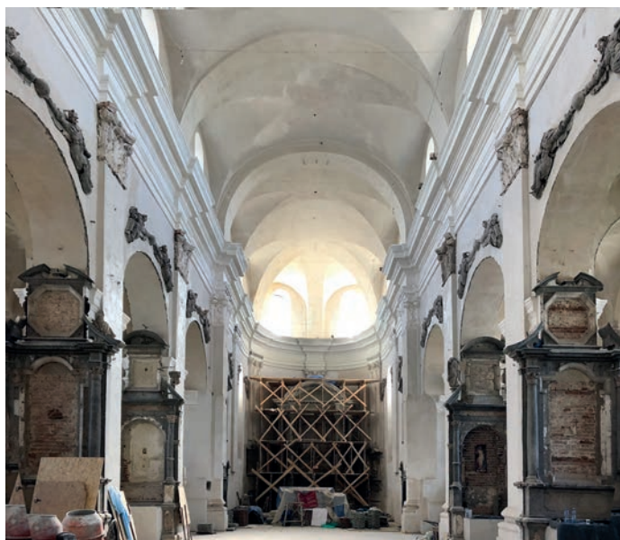
VII/47. Olyka. Interno della collegiata – in direzione del presbiterio – nel corso dei lavori di conservazione, 2019.
